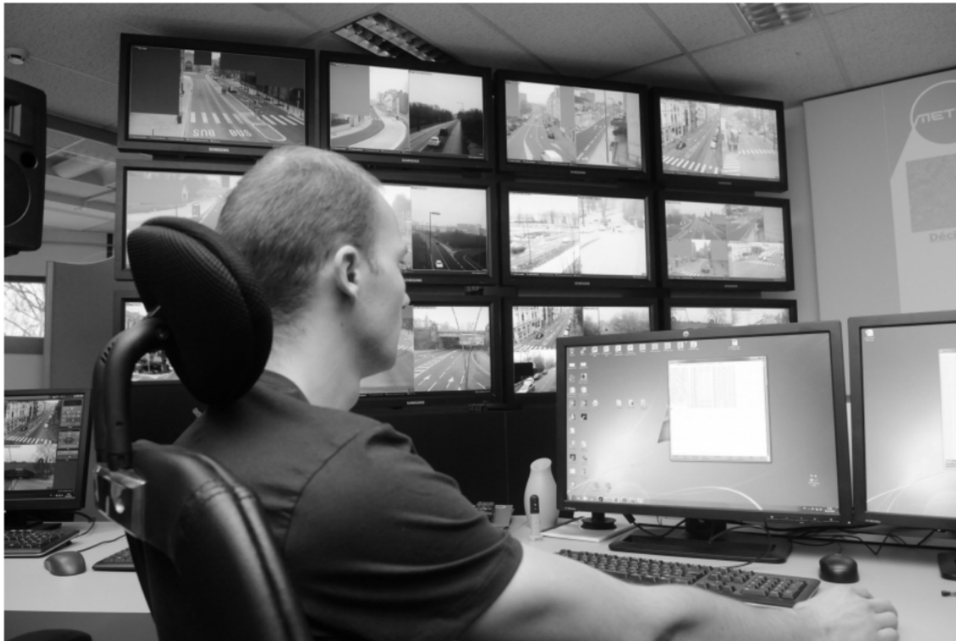
Centre de contrôle de la circulation, ville de Metz
